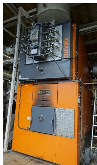
木質チップボイラー
