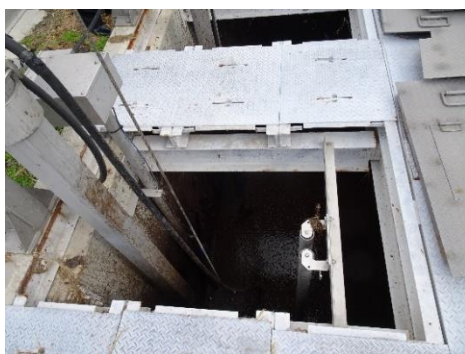
畜舎後方のピットに、バーンクリーナーでふん尿が自動投入される。ここから原料槽へ圧送される。
