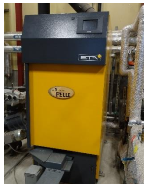
ペレットボイラー
