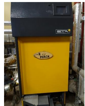
チップボイラー
